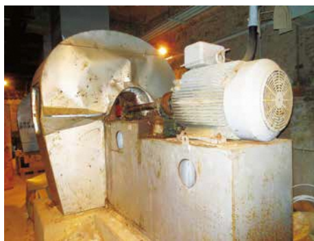
故障した焼却炉の誘引送風機
